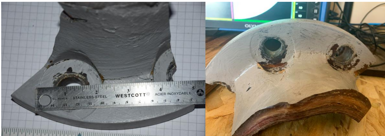
Рис. 2. Трещина между отверстиями под болты в образце, вырезанном из фланца FRP
